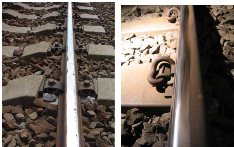
写真1 レールに生じる波状摩耗の例
