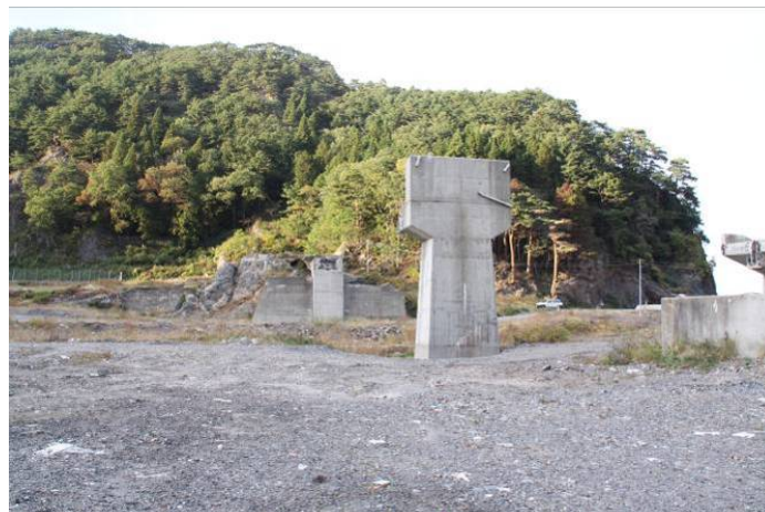
写真 3 三陸鉄道北リアス線島越駅の津波被災状況（駅舎を含め、周辺の構造はほとんど残ってない。1基残った橋脚の損傷状態から津波外力を逆解析できればと考えている。）
