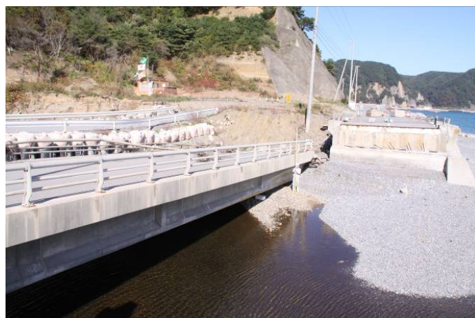
写真 2 岩手県北部沿岸部にて津波により落橋した橋梁（津波による落橋メカニズム、津波外力を逆解析できればと考えている。）
