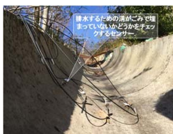
排水溝の目詰まり状態を把握するための Gap センサー
