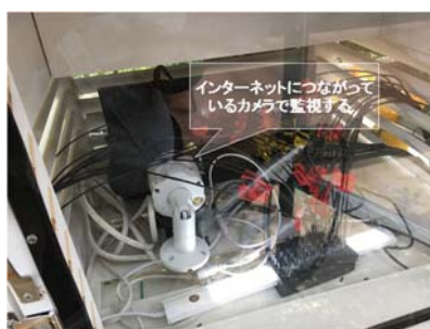
POF センサーの情報を集約したボックスをインターネットに接続されたカメラで監視している様子。この映像は世界中のどこにいても確認できる。
