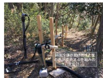
斜面の動きを監視する変位センサーと地盤内に挿入された水分検知センサー
