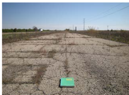
写真-1 50年経過した路面
