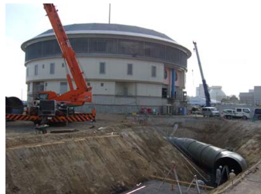
■ ネットワーク幹線とネットワークポンプ場
