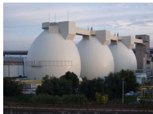
■ 汚泥消化タンク
